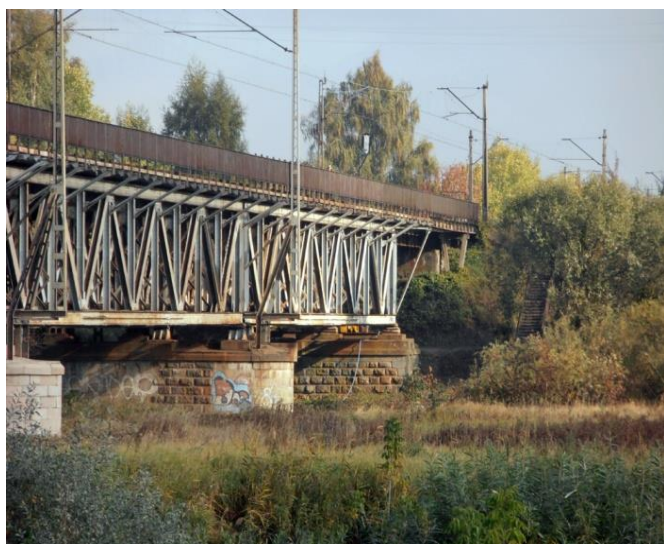
Zdjęcie 5. Stan konstrukcji przed renowacją
