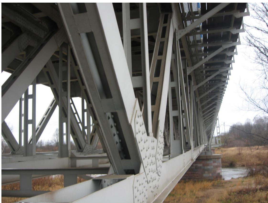
Zdjęcie 3. Stan konstrukcji - 2 lata eksploatacji.
