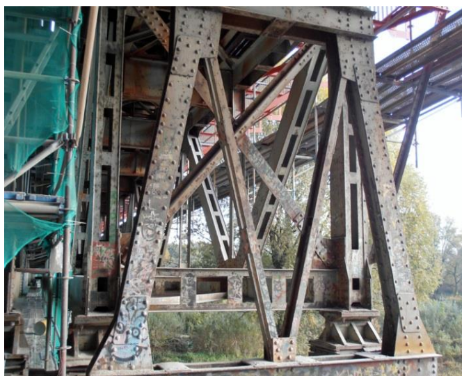
Zdjęcie 7. Stan konstrukcji przed renowacją
