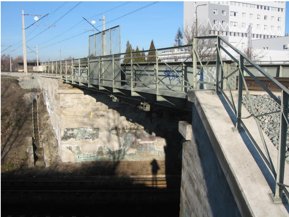
Zdjęcie 5. Most kolejowy Opole ul. Głogowska – stan powłok 8 lat od aplikacji.
